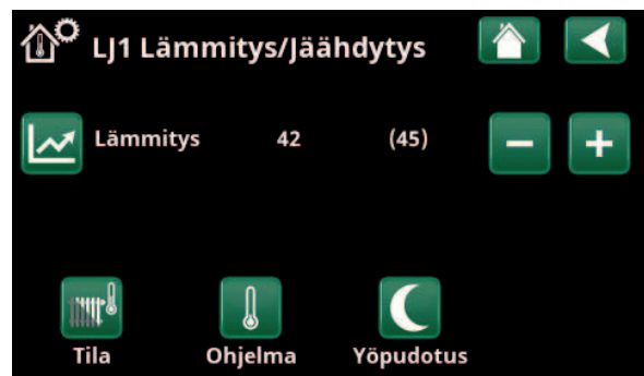
Valikko "Edistyneellinen/Määrittele/Lämmityspiiri/Lämmityspiiri 1". Lämmityspiirissä ei ole huoneantureita. Asetuspiste (menoveden lämpötila 45 °C) näkyy suluissa, nykyinen menoveden lämpötila 42 °C näkyy asetuspisteen vasemmalla puolella.
